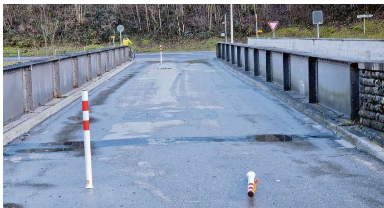
Freie Fahrt über die «gesperrte» Linthbrücke: Unbekannte haben zwei Pfosten aus der Bodenverankerung herausgerissen. Bild Martin Meier
